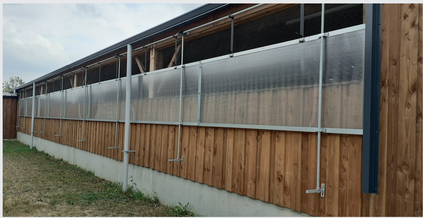
Chèvrerie équipée d'un rideau ascenseur
