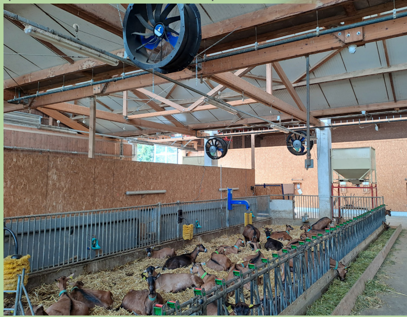
Mise en place de ventilateurs dans la chèvrerie de Patuchev, pour mieux évacuer l'air chaud la nuit lors de pics de chaleur
